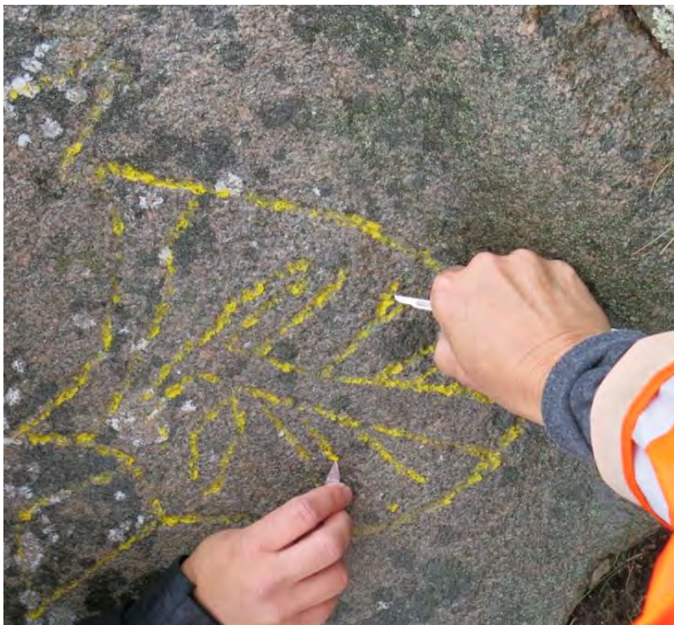
Bild 5: Under skadeinventeringsdagen i fält kontrollerades det hur hårt den flagnande färgen satt fast. Det visade sig att den i många fall var lätt att lyfta bort med hjälp av en vass skalpell som kilades in mellan flaga och häll.
