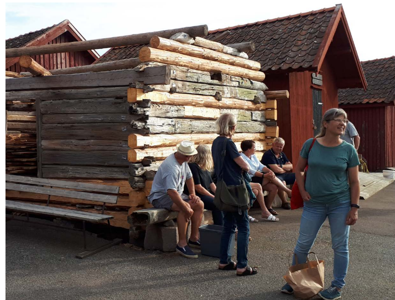
Kulturvandring på Stora Kornö för deltagare på Näverkärrs byggnadsvårdsläger i juli. Deltagarna sitter vid en av Stora Kornös äldsta sjöbodar som håller på att restaureras, det ljusa timret är nytt. Sjöboden sägs vara från 1600-talet men har stått på platsen sedan 1700-talet. Foto: Bohusläns museum.
