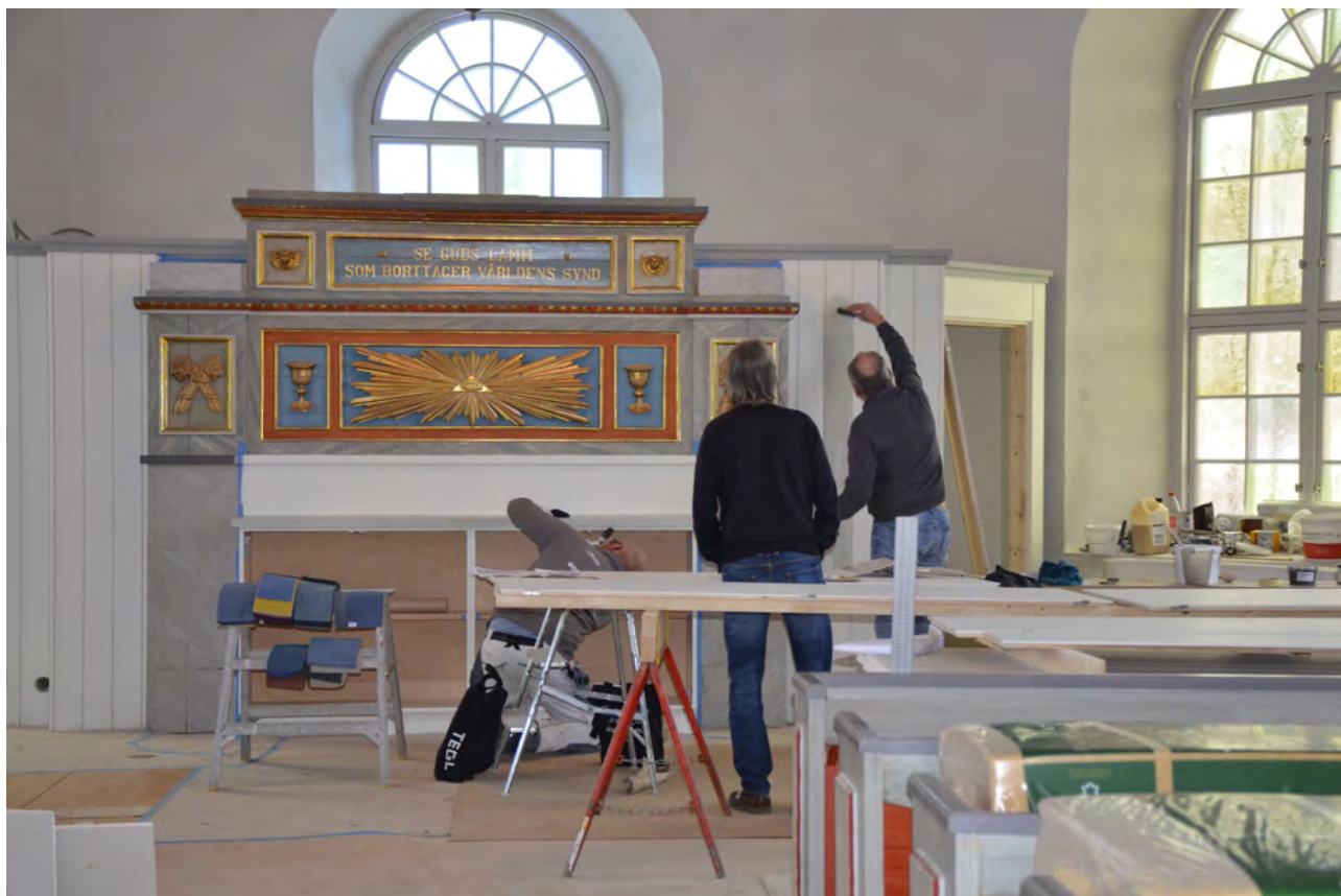
Museet följer många kyrkorenoveringar som antikvarisk medverkande. Här pågår byggmöte i Långelanda kyrka, som genomgått en stor renovering 2018-2019. Foto: Bohusläns museum
