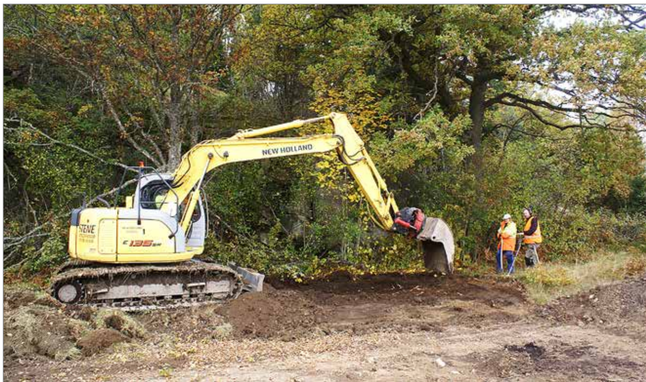
Figur 31. Pågående schaktning i åkern söder om bergknallen vid Herrestad 415. Här grävs schakt 3 och intill skopan står Marianne Lönn och metalldetekterare Jonas Paulsson. Foto mot norr, Johan Peterson.
