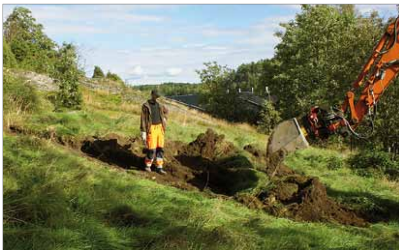
Figur 5. Joakim Åberg schaktar vid graven A102 i schakt S115. Foto från väst: Oscar Ortman.
