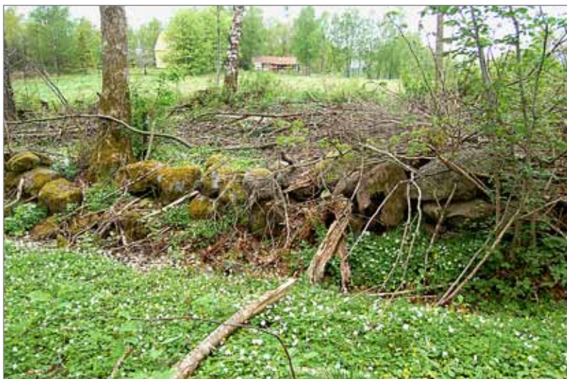
Figur 7. Den äldre färdvägen är kantad av delvis utrasade stenmurar och grunda diken. Murarna är skadade av träd, och vägytan är belamrad med ris. Foto mot västnordväst, Niklas Ytterberg.
