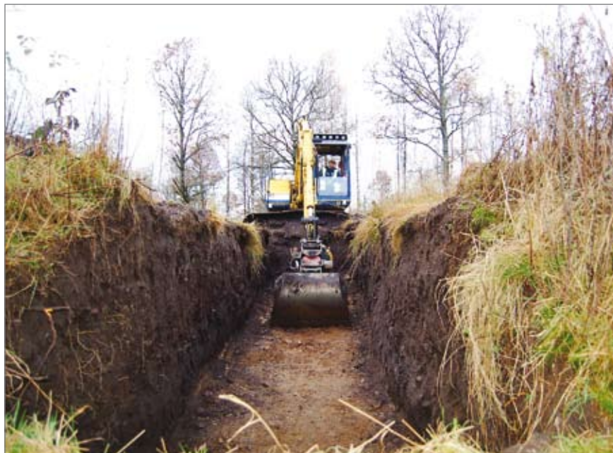
Figur 21. Arbetsbild med grävmaskinen i andra änden av djupschaktet S3208. Foto: Anna Gustavsson.
