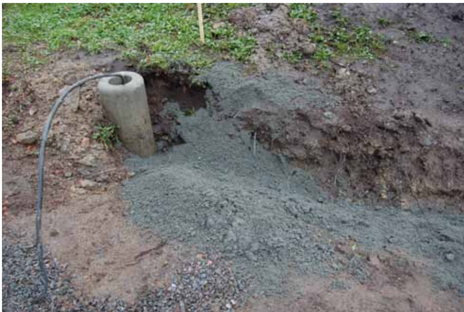
Bild 4. Kabelschakt i nordvästra hörnet av undersökningsområdet. Även här är det inte längre möjligt att dokumentera lämningar. Vy mot nordväst.
