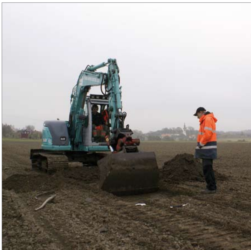
Figur 15. Mattias Öbrink övervakar schaktning i åkermark inom utredningsområde D:2, i bakgrunden syns Solberga kyrka. Christer Carlson sitter vid spakarna på grävmaskinen. Foto Jonas Svensson.
