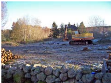
Figur 4. Vy över området före undersökningen. Framför trädriddån till vänster i bild grävdes schakten 1, 2 och 5. Husgrunden är belägen en bit till höger om maskinen men utanför bilden. Foto mot norr, Andreas Toreld.
