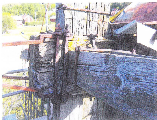
Rötskade vingar samt axel. Järnbeslagen kring axeln.
