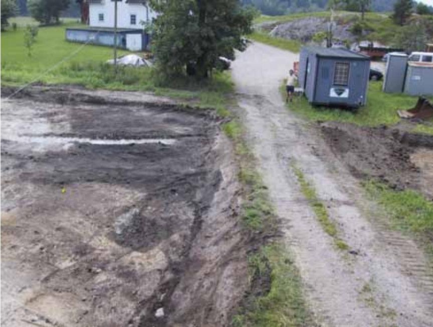
Figur 4. Skärvstensflaket A1996 framschaktat. Flaket låg under det äldre matjordstäckets A2922 och fortsatte in under gårdstomten. Bilden är tagen mot söder. Foto: M. Lindqvist.
