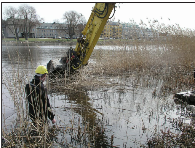
Figur 3. Sökschaktgrävning i vassbältet utanför Tidans västra strand. På bilden syns Staffan von Arbin övervaka schaktningen. Foto: Jens Lindström, Bohusläns museum.
