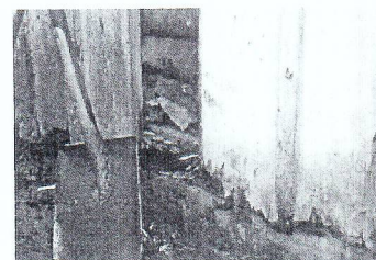
Närbild på rötskada i och bakom panel, i samma hörn av byggnaden som på fotot nedan.
