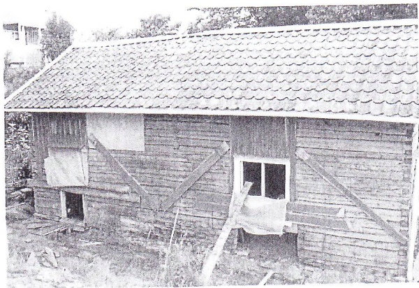
Västfasaden efter det att panelen tagits ned. Partiet under fönstret var redan tidigare avlägsnat p g a rötskador.
