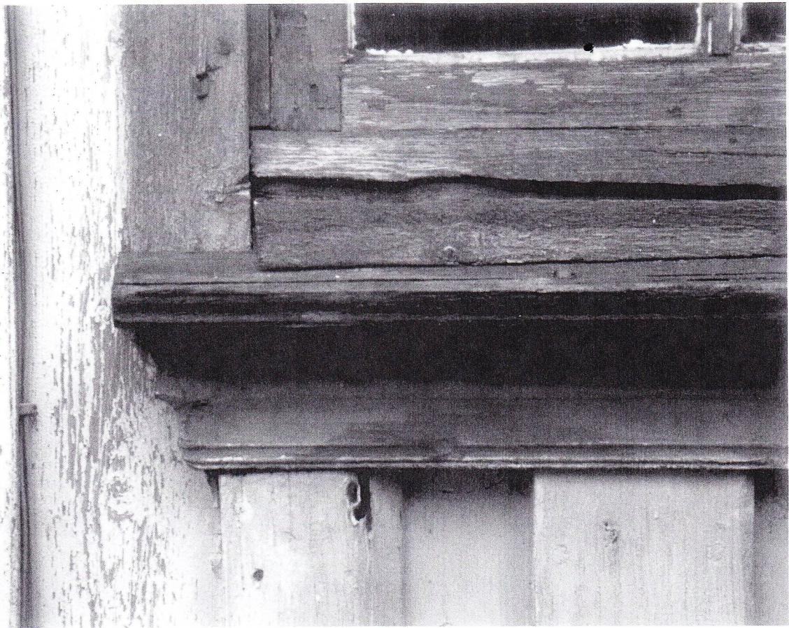
Detalj av skadat fönster på värdshuset Foto Tomas Brandt, Bohusläns museum
