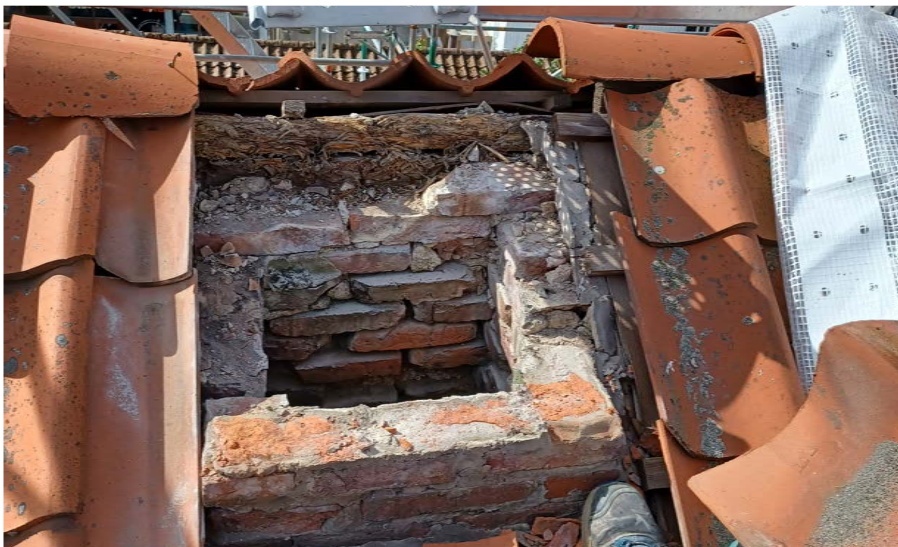
På byggnadsminnesförklarade Kaptensgården i Grebbestad var skorstenar och murstockar i dåligt skick. Intressanta diskussioner fördes om hur detta skulle lösas. Foto: Bohusläns museum.
